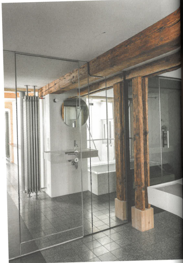
Zahllose Passstücke prägen die Reparatur des dreigeschossigen Altbaus, darunter ein neues Stützenauflager ...
